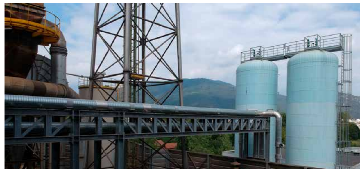
Alfa Acciai: sistema di tubazioni di alimentazione dell'impianto recupero calore dall'acciaieria e serbatoi di accumulo
